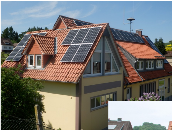
Photovoltaikanlage auf dem DGH-Willensen
