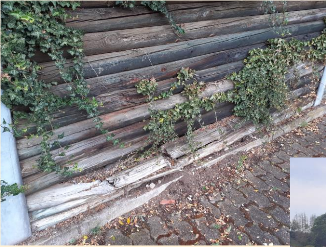
Schäden an den Stützhölzern
